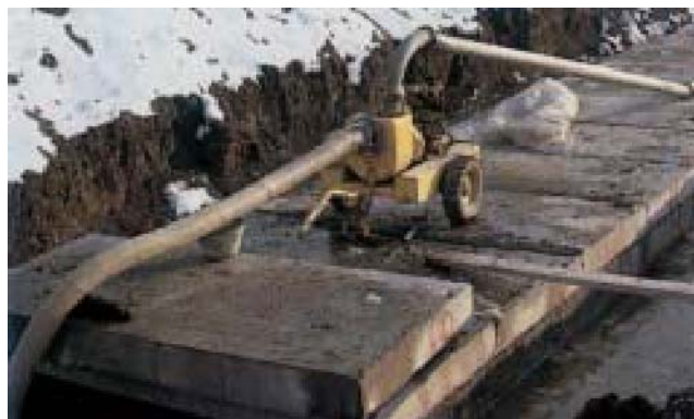
Насос J156-5. Подача сточной воды в обводного канал.
